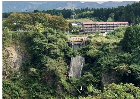
崩落した旧阿蘇大橋の橋桁
