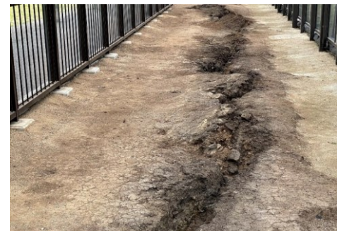
地表地震断層
