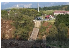
旧阿蘇大橋の橋桁 (南阿蘇村)
