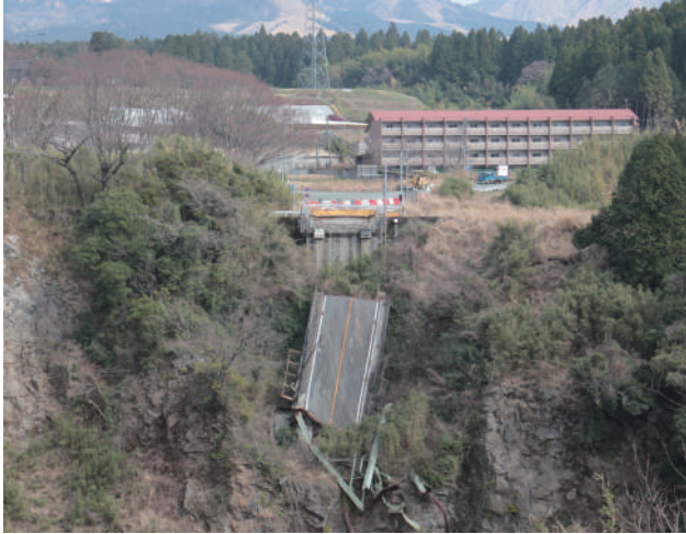
▲数鹿流崩之碑展望所からは旧阿蘇大橋の残った橋桁がみられる
